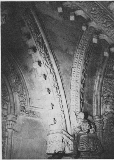
Abb. 2: Gewölberippe a, aus Ecke A aufsteigend
