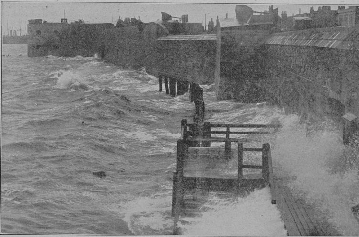
Der alte Hafen von Portsmouth, der jüngst von einer Sturmflut heimgesucht wurde, die die Mauern stellenweise zertrümmerte und alle Straßen tief unter Wasser setzte.
