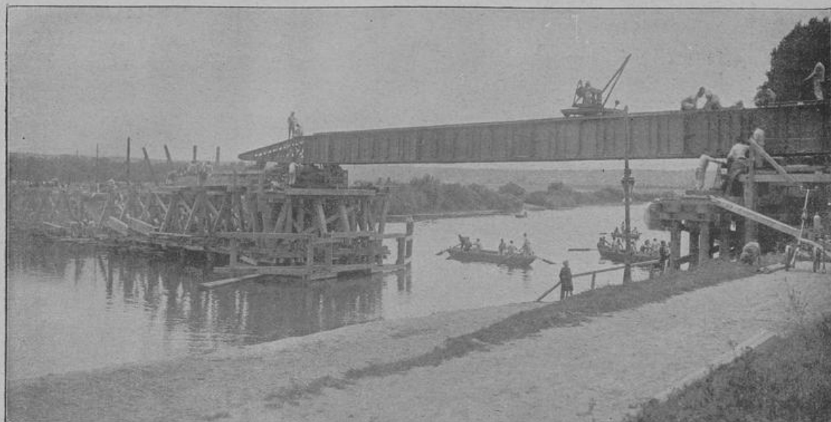
Bau einer Eisenbrücke über die Marne bei Meaux durch das 5. französische Genieregiment.
