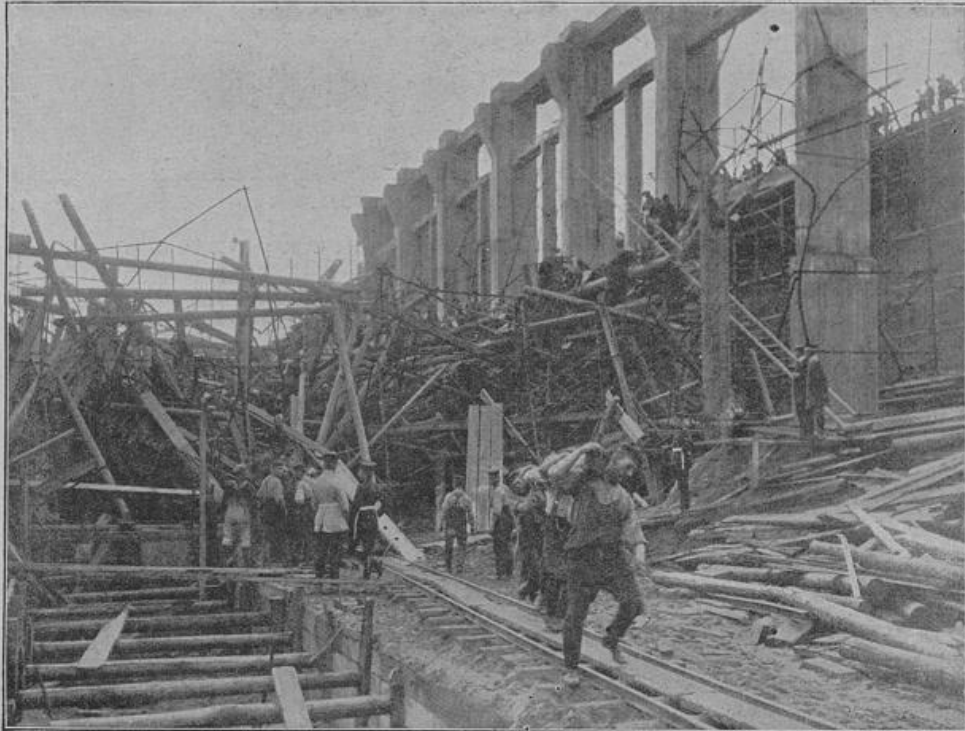
Zum Einsturz der Maschinenhalle des Großkraftwerkes Franken in Nürnberg: Blick auf die Trümmerstätte. Electro-Photo-Co., Nürnberg.
