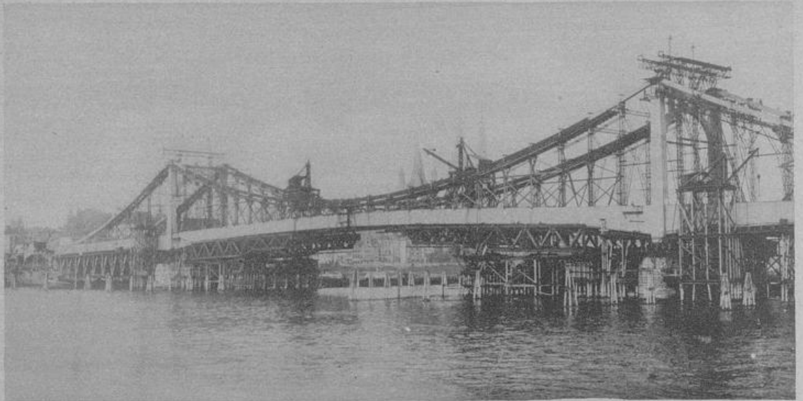
Die neue Hängebrücke bei Köln über den Rhein in ihrem jetzigen Bauzustand.
