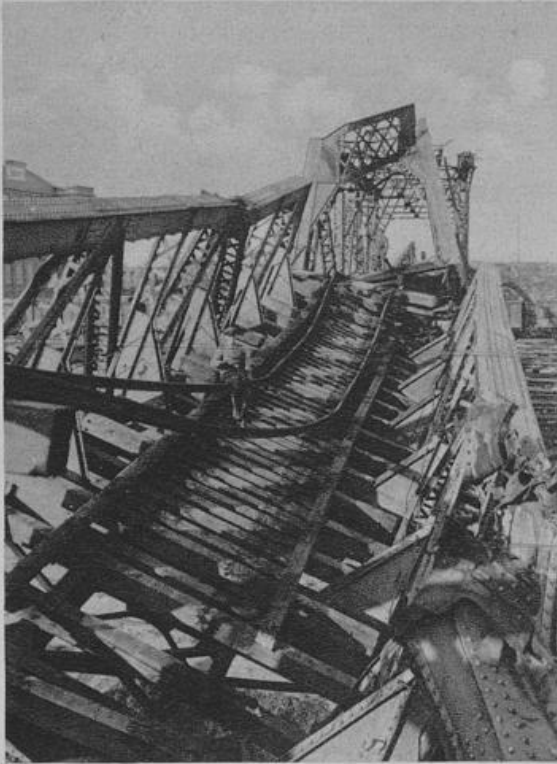
Blick auf eine von den Russen gesprengte, jetzt von deutschen Soldaten bewachte Eisenbahnbrücke bei Giensohan. U. Strohs.
