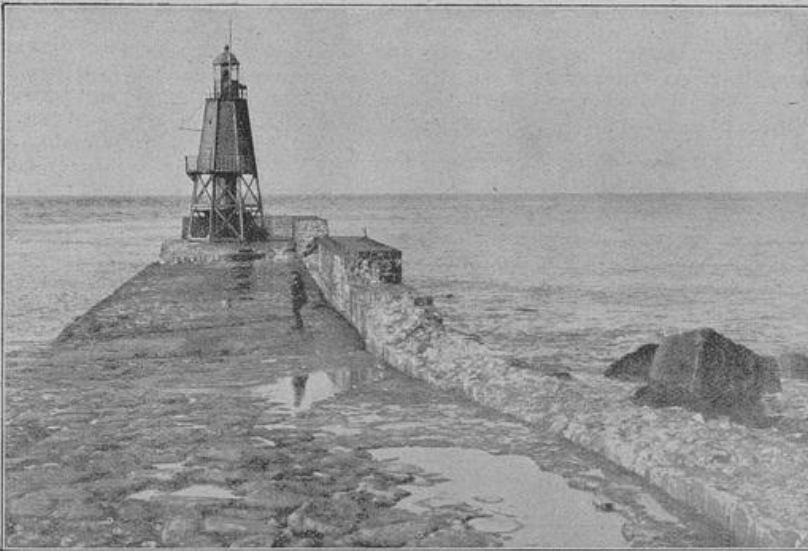
Der Kopf der Ostmole von Swinemünde nach der Sturmflut. M. Dreblow, Stettin.
