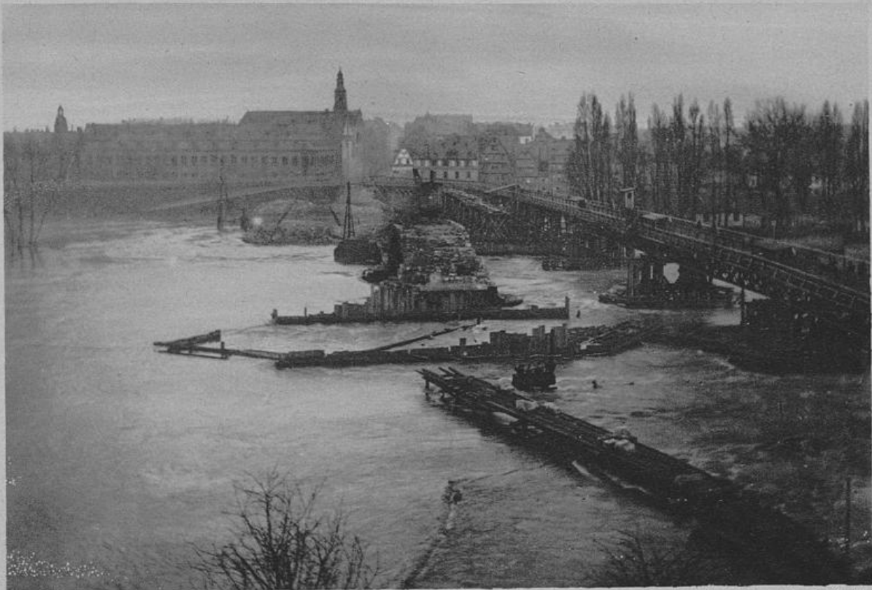
Hochwasser des Mains bei Frankfurt. Die schwer beschädigte Baustelle an der alten Brücke. Phot. P. Beutler.
