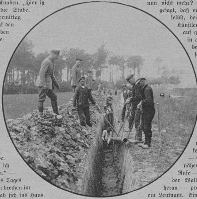
Frisches Trinkwasser für unsere Truppen im Westen: Bau einer Wasserleitung dicht hinter der Front bei Ypern.
